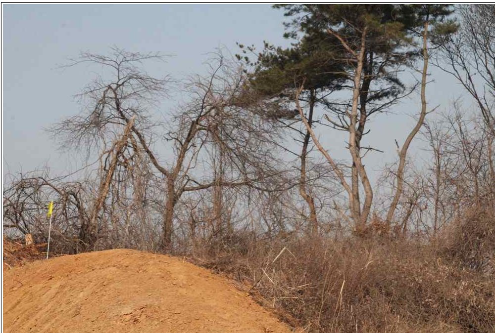
【그림 6】 상부 자연비탈면 (수목의 기울어짐 및 포행)
