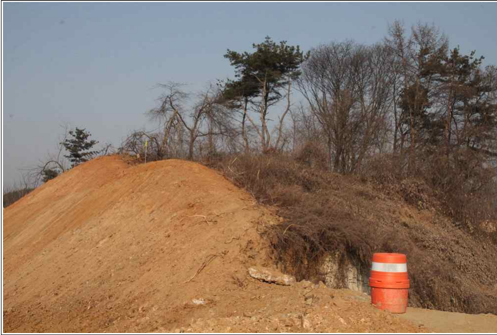
【그림 5】 상부 자연비탈면 (수목의 기울어짐 및 포행)
